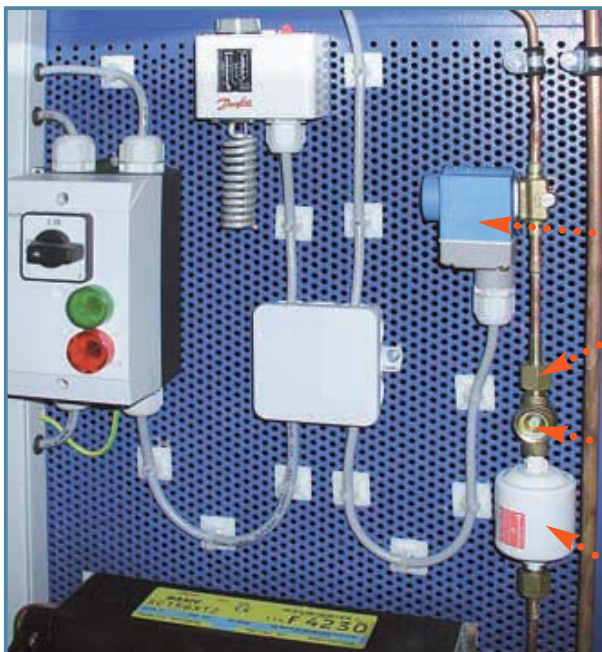
Nainštalované prvky chladiaceho systému
